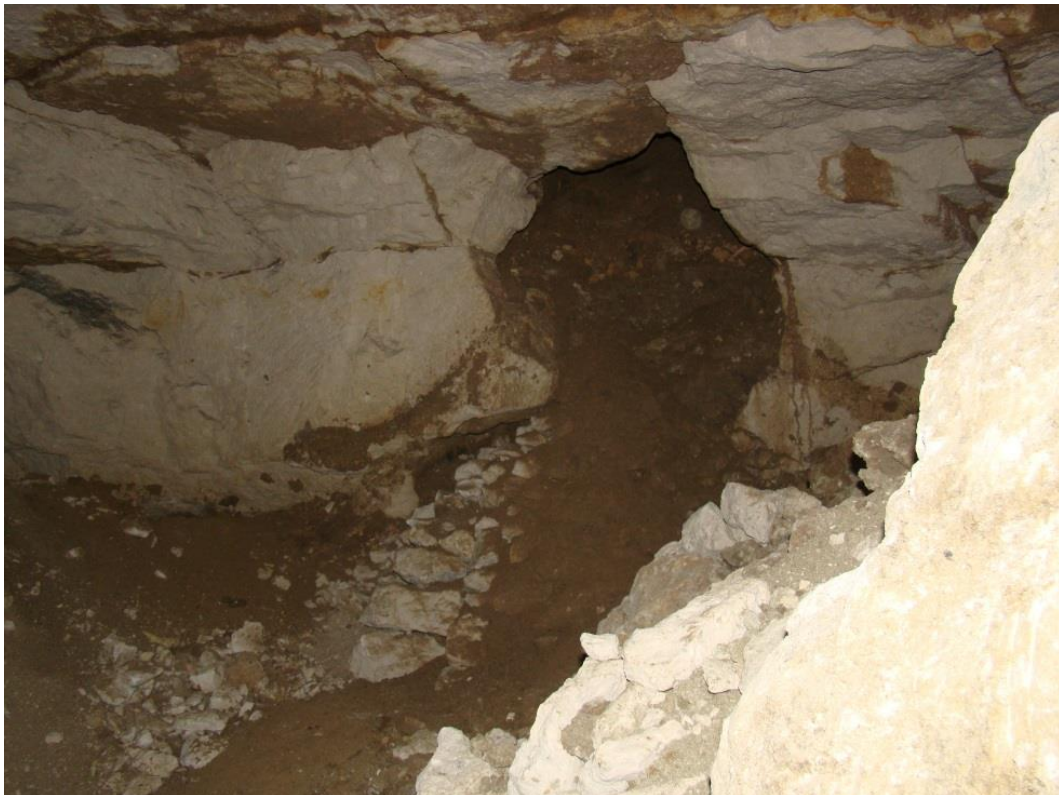
Illustration 10 : Secteur sud – cloche de fontis sous le talus de la RD9
