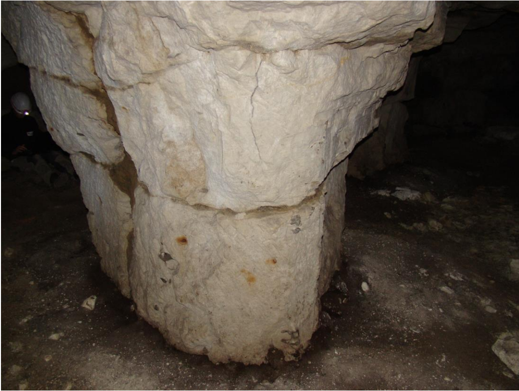
Illustration 8 : Secteur nord – fissuration mécanique d'un pilier traversé par des conduits karstiques horizontaux et verticaux
